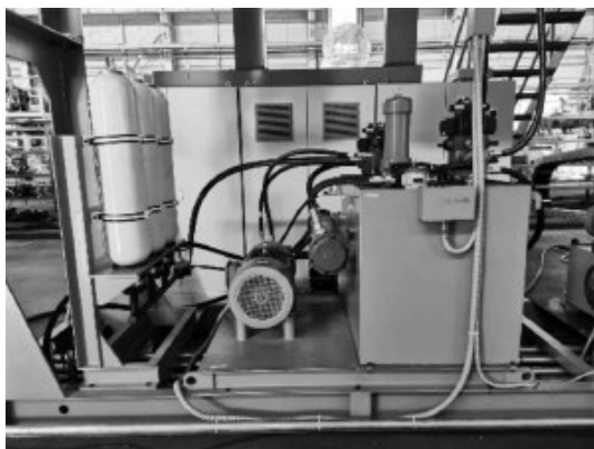
图 1 双泵液压系统实物图
